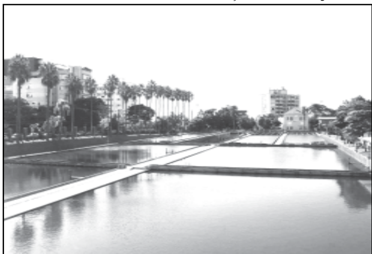
Estação de Tratamento de Água Moinhos de Vento
