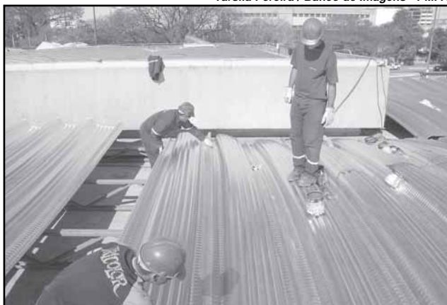
Telhado apresentava problemas estruturais desde a inauguração do prédio
