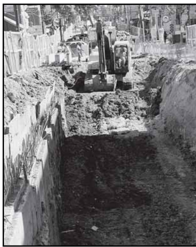
Entre as ruas Bordini e Mata Bacelar estão sendo realizadas as escavações com aproximadamente 12 metros
