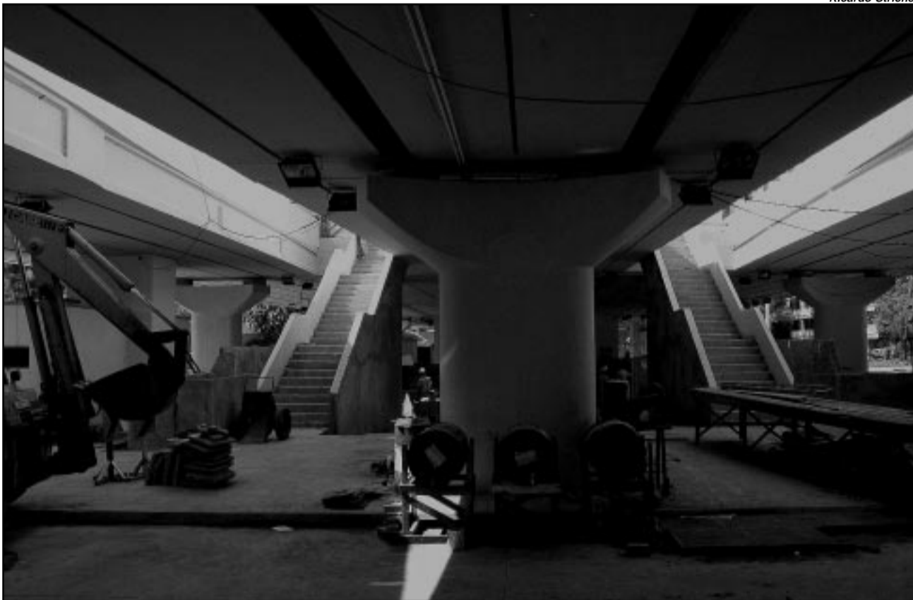
Equipes realizam até o final da semana trabalhos de acabamento, como os passeios
