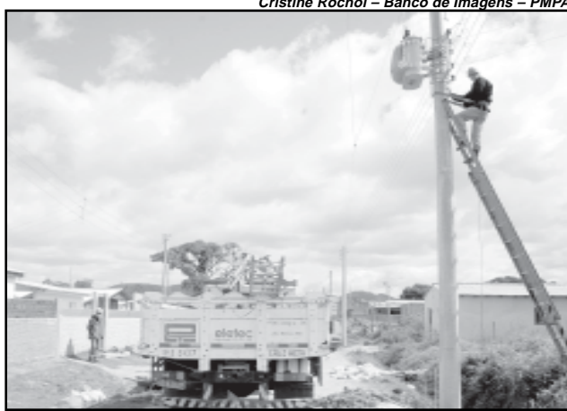
Cristine Rochol – Banco de Imagens – PMPA A prefeitura entra com as obras de infra-estrutura para as cooperativas, o que representa em torno de 60% do custo
